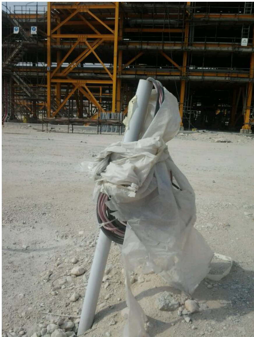
عکس شماره ۱۶: عکس دیگری از عایق نامناسب کابل های برق در منطقه ویژه پارس جنوبی
